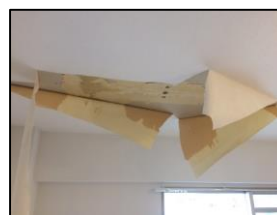
雨漏りの状況
