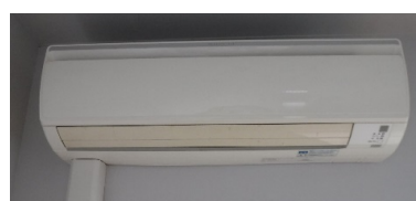
エアコン(南側2部屋)
