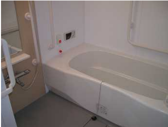
高齢者対応型浴室 (緊急通報付)
