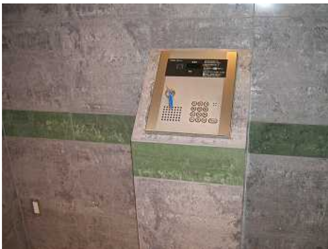
エントランス (オートロック)
